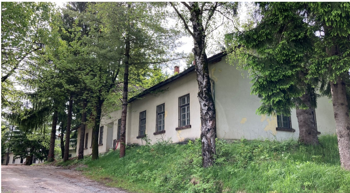
Slika 5 Pogled na severno in zahodno fasado dotrajanega objekta z dovozno potjo, z dne 18. 5. 2021
