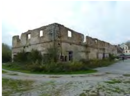
Pogled na porušeno S in V fasado zidanega gospodarskega objekta (4), z razvidno originalno členitvijo fasade in originalnim gradivom (kamen).
