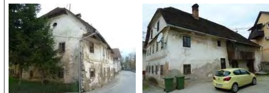
Zaradi poškodb ometa je razvidno originalno gradivo objekta na S fasadi.
