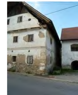
Vidne poškodbe na stiku čela s strešino. Poškodovan omet.
