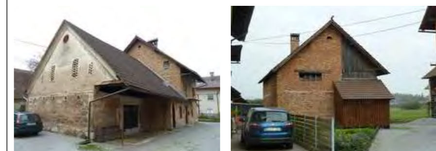
Poškodovan omet S in V fasade razkriva originalno gradivo (kamnite stene)
