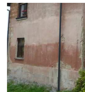
Poškodbe na fasadi objekta
