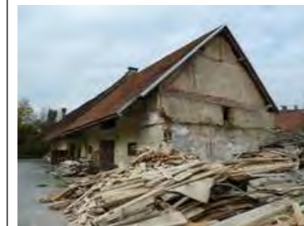
Pogled na gospodarski objekt iz JV smeri. Objekt je delno porušen.
